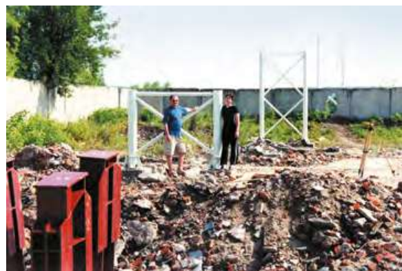
2001 год. Город Озёры. Строительство испытательного полигона струнного транспорта. Рядом – моя супруга Надежда Косарева, сотрудница моей инжиниринговой «Научно-производственной компании Юницкого»
